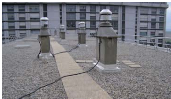
La copropriété a opté pour une ventilation naturelle hybride auto réglable avec extracteurs d'air motorisés en toitures.
