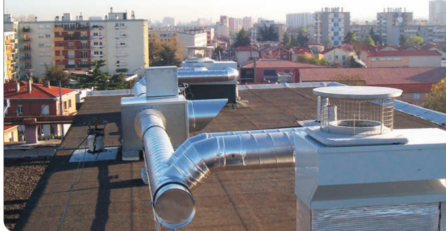
Le système de ventilation Séren'air (MVN).
